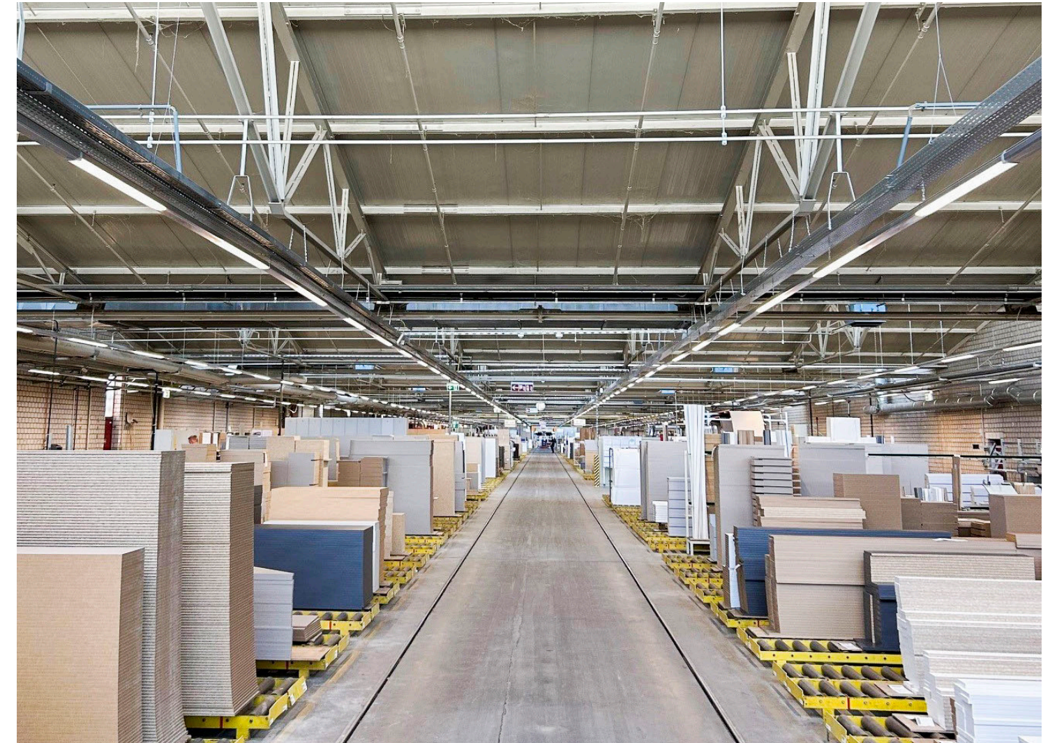
Umrüstung der Beleuchtung auf LED in der Produktionshalle in Freudenberg.
